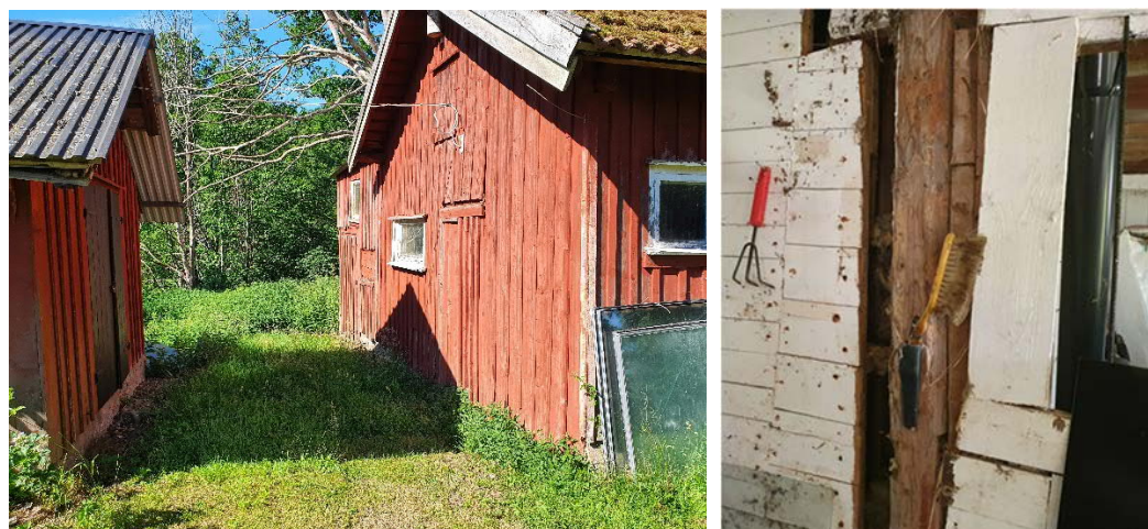
Figur 21 Spricka i vägg mellan uthus och tillbyggnad (Hjärtums-Brattorp 1:7). Datum 2020-06-26.
