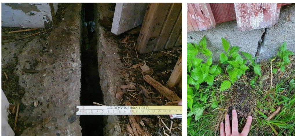
Figur 22 Spricka i golv och grund mellan uthus och tillbyggnad (Hjärtums-Brattorp 1:7). Datum 2020-09-03.
