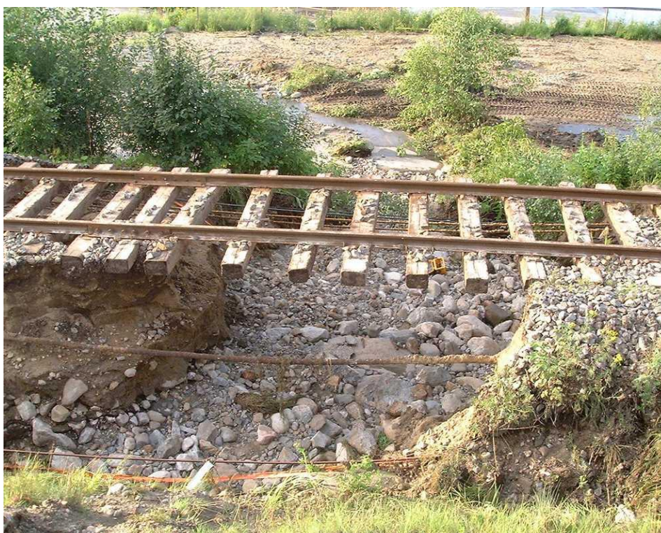
Figur 5-3. Underminering av järnväg vid Väja, Kramfors. Foto: SGI
